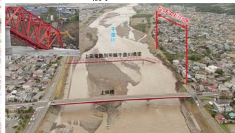
② 上田諏訪形の堤防欠損
